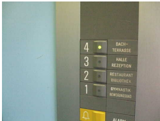
Bedienelemente Aufzug Foyer
