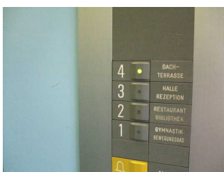
Bedienelemente Aufzug Foyer
